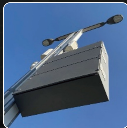
北京市政路灯控制箱
