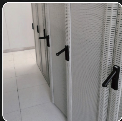
山西大同电信IDC机房
