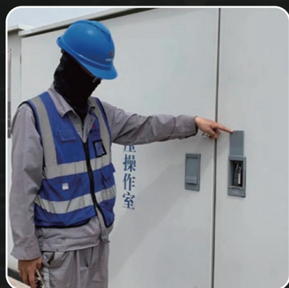
内蒙光伏场站
