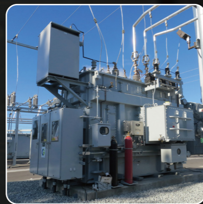
南通国家电网变电站
